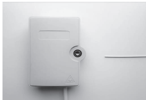
Hausübergabepunkt, in dem das offene Ende des Selbstmontagesets mündet (Abb. 2).
